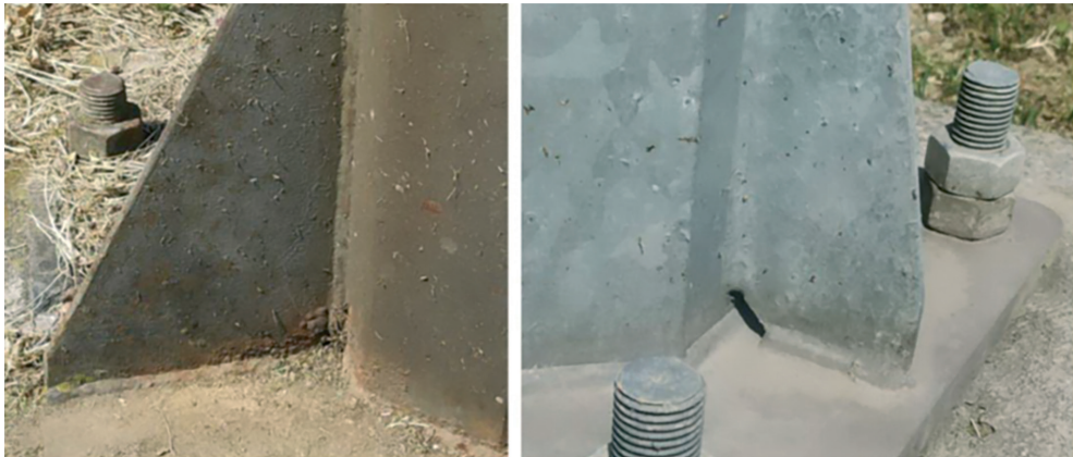
Slika 20. Lijevo – loše rješenje (pojava korozije zbog nakupljanja zavara na oštrim kutovima), a desno – dobro konstrukcijsko rješenje (mali džepovi eliminiraju nakupljanje zavara i pružaju bolju drenažu) [13]
